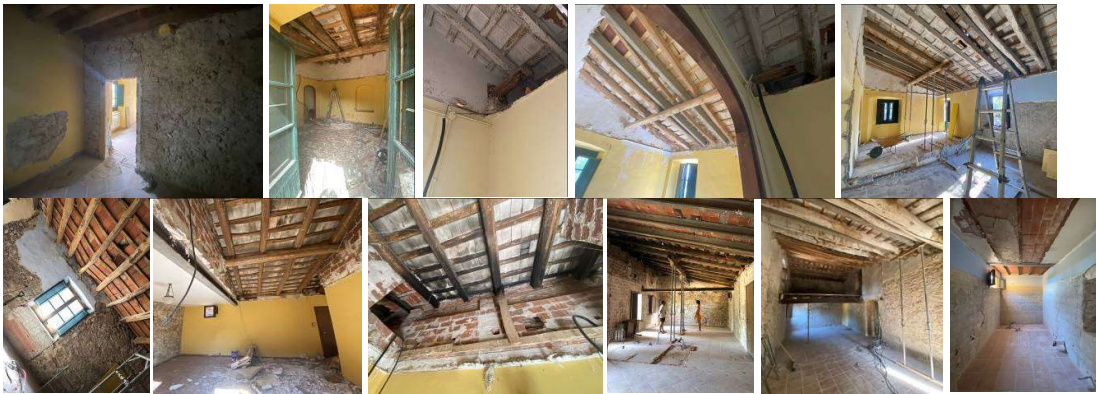
EXEMPLES DE L'ESTAT DE LES COBERTES EN CLAR RISC D'ENSULSIADA EJEMPLOS DEL ESTADO DE LAS CUBIERTAS EN CLARO RIESGO DE DERRUMBE
