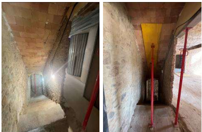
ESCALA PRINCIPAL AMB ESQUERDES I PROTEGIDA PER A LA SEVA REHABILITACIÓ ESCALERA PRINCIPAL CON GRIETAS Y PROTEGIDA PARA SU REHABILITACIÓN
