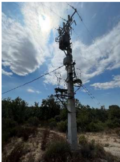
CENTRE DE TRANSFORMACIÓ CENTRO DE TRANSFORMACIÓN
